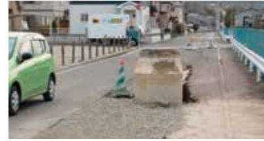
出典:財団法人消防科学センター 東日本大震災 液状化によるマンホール等浮き上がり
