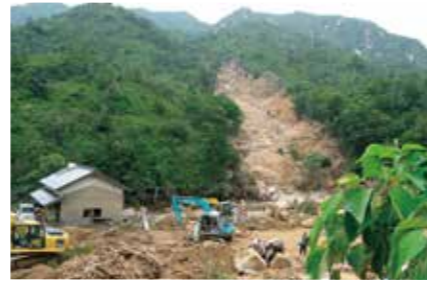
出典：財団法人消防科学センター 平成21年(2010年)7月 中国・九州北部豪雨 山口県防府市
