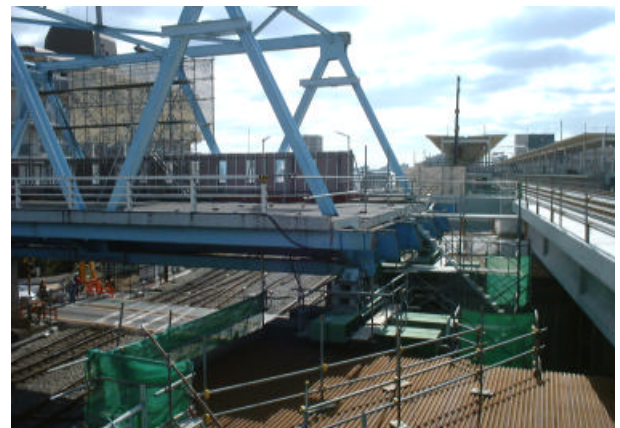
【加古川・小野線落橋部分及び新高架橋(右端)】
