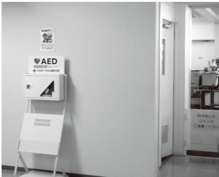
▲加古川市役所内に設置されているAED
