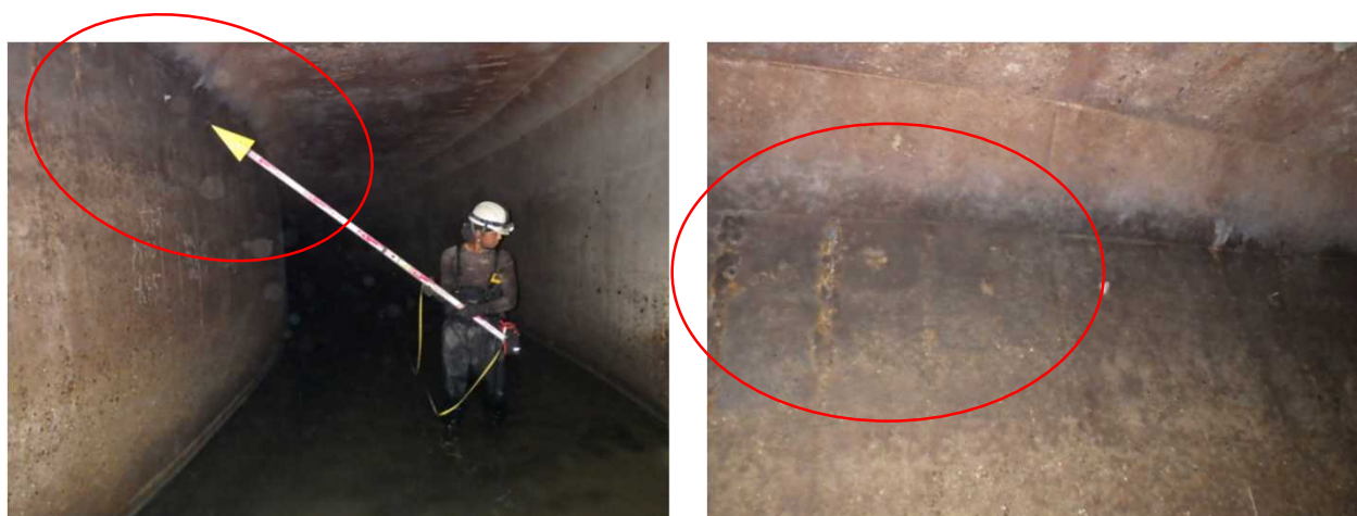
浸入水（地下水）がにじんでいる
