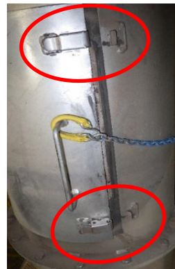
【防火ダンパ下部ダクト点検口留め金具】
