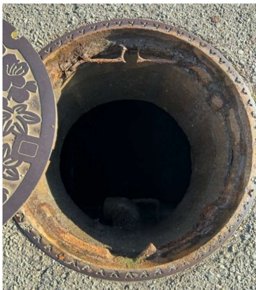
【写真②】 蓋が開いている状態 事故前は閉まっていた。
