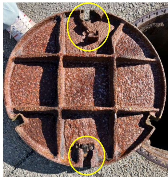
【写真③】 蓋の裏側 蓋と受枠を接続する金具が外れている。
