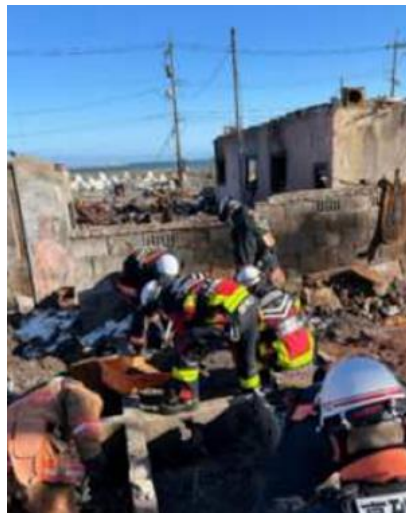
大規模火災現場（河井町）
