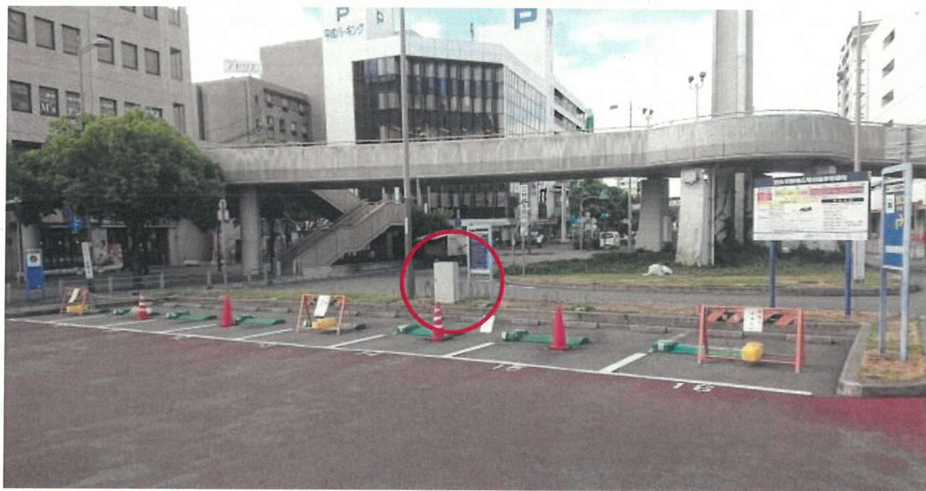
⑥ 加古川駅南広場自動車整理場、分電盤
