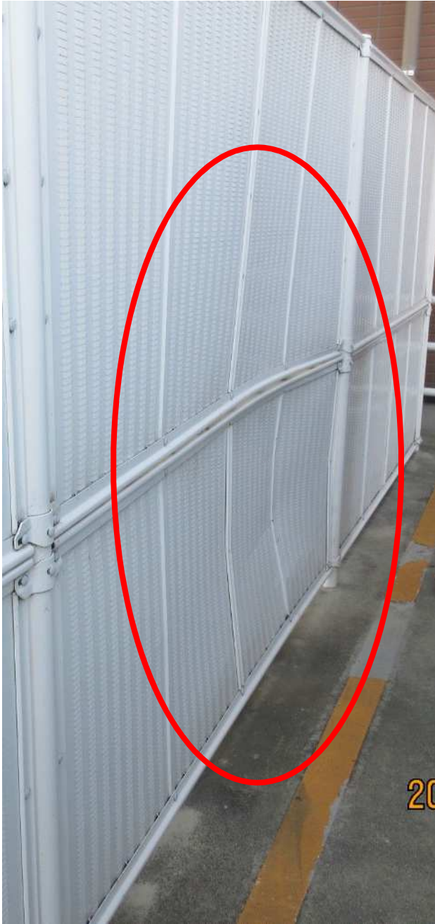
フェンス損傷箇所
