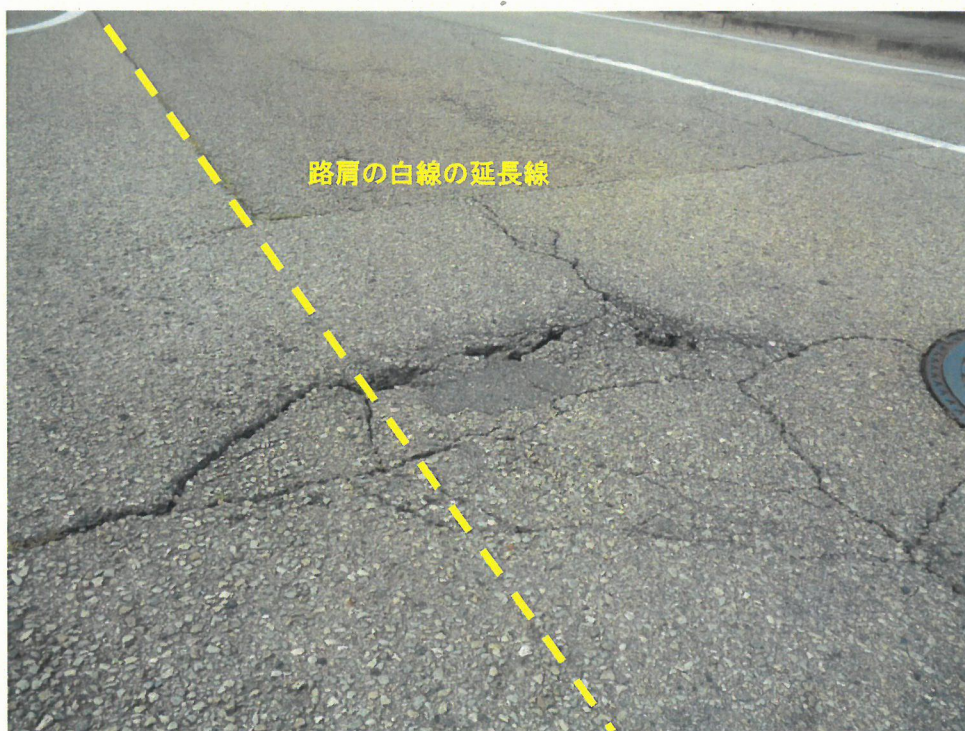
ひび割れ及び
