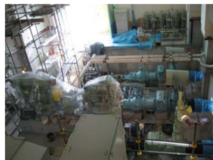
▲完成した1号ポンプ (写真中央左)
