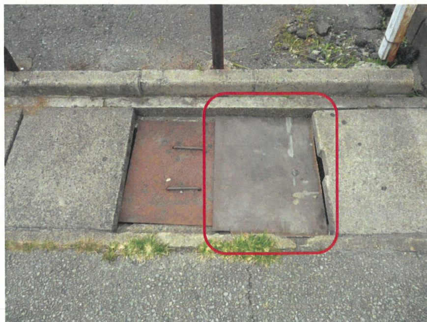
←後から設置されたと思われる鉄板
