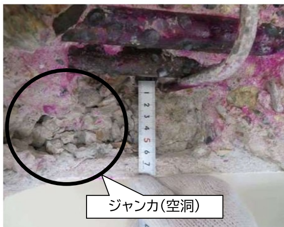
【劣化度Ⅲ(ジャンカあり)】
