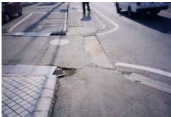
写真 道路と歩道の接続部の段差や急勾配
