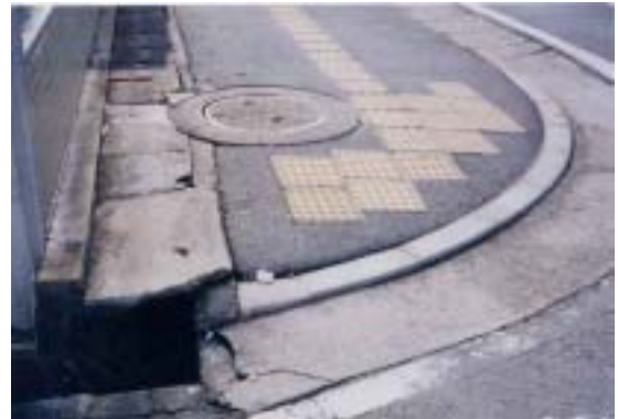
写真 蓋が破損している側溝
