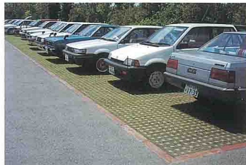
駐車場に透水性のある芝生ブロックを施しています。
