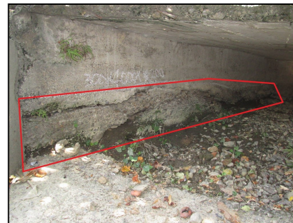
下部工に剥離・鉄筋露出が見られます
