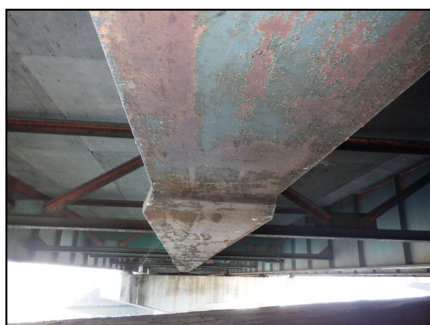
主桁に腐食が見られます
