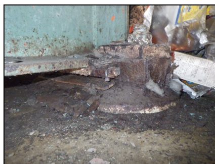
支承に腐食が見られます
