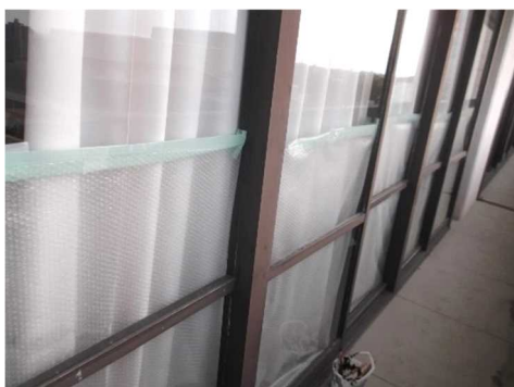
窓に断熱シートを貼り、断熱効果を高め、空調機器の効率を向上
