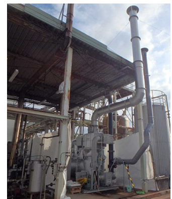
更新した脱臭焼却炉
