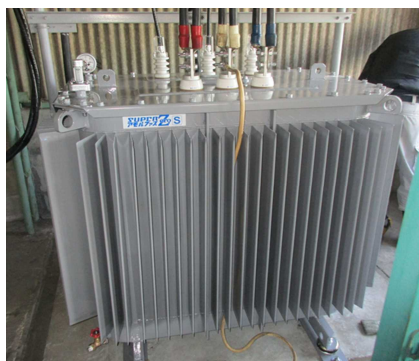
ア. 高効率変圧器に更新
