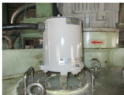
エ. 反応槽透視灯のLED化
