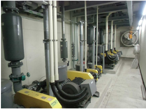
防音室に設置したブローポンプ
