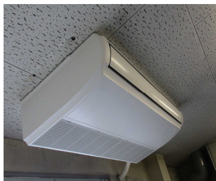
イ. 省電力エアコンに更新
