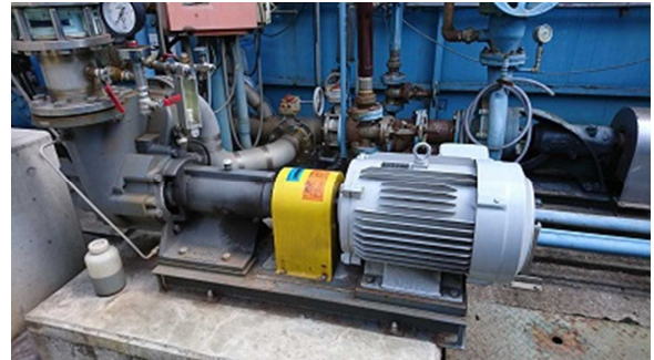
二次加圧浮上槽循環水ポンプ(写真②)
