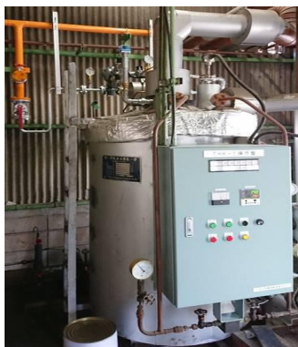
（ア）屋外P 熱媒ボイラー
