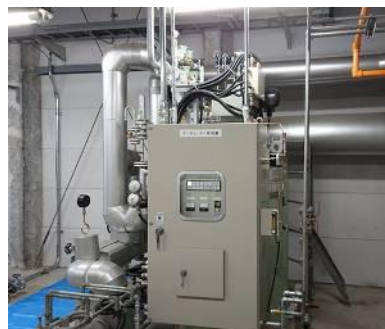
（イ）FPC 熱媒ボイラー
