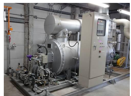
（ウ）FPC 排ガス焼却炉
