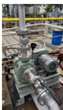
沈殿槽汚泥返送
