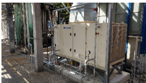
地下水利用冷房システム導入
