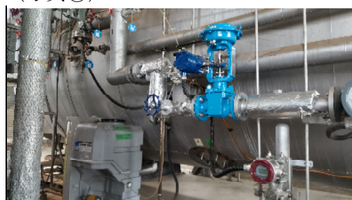
FTボイラーの給水自動制御装置
