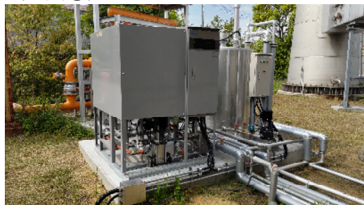
排ガス利用 沸騰排水中和設備
