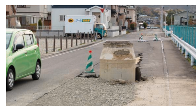
出典:財団法人消防科学センター 東日本大震災 液状化によるマンホールなど浮き上がり
