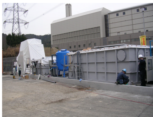
排水処理設備 1月29日
