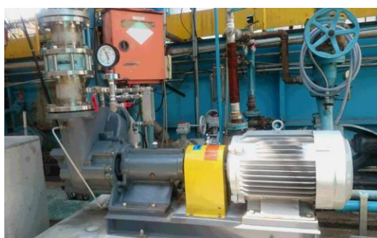
循環水ポンプ (写真①)
