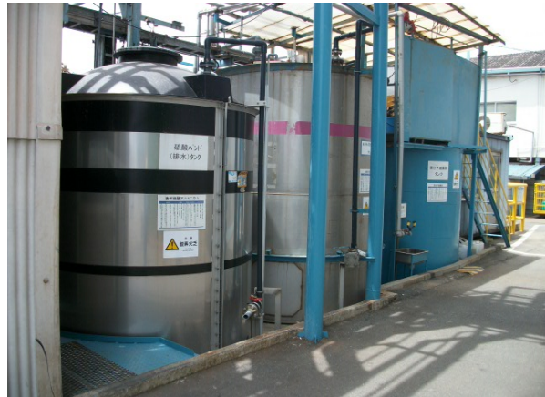
手前：硫酸バンドタンク 平成25年10月設置
