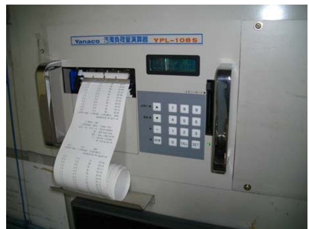
図4 水処理設備 COD汚濁負荷演算器
