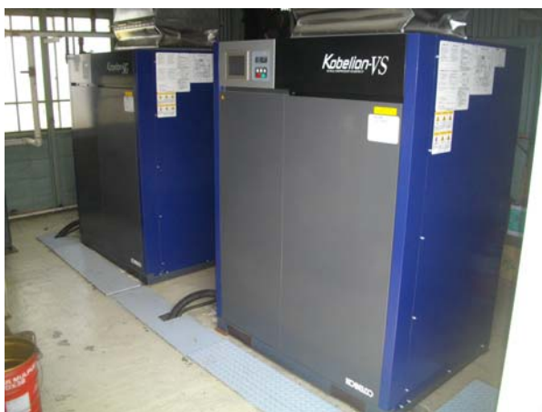
図3 高効率コンプレッサー
